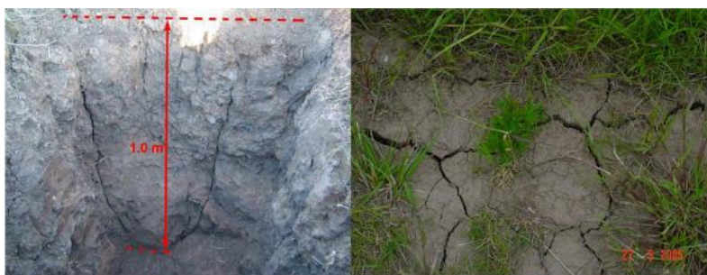
Figure 11 : Exemple de fissures de retrait sur des digues en Angleterre 64
